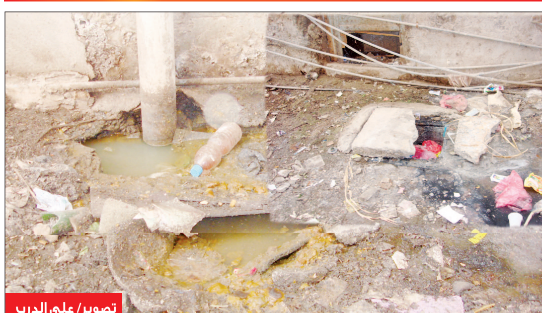
نتيجة لإهمال جهات الاختصاص في محافظة عدن ورغم ما يدفعه المواطن للصرف الصحي أصبحت نقاط المجاري في الأحياء والشوارع بهذا الشكل الذي يتسبب بأضرار صحية كثيرة للسكان وما يشكله من مخاطر على أساسات المباني وما سينجم من مخاطر تهدد الجميع إضافة إلى تشويه المنظر العام فمن المسؤول ؟
