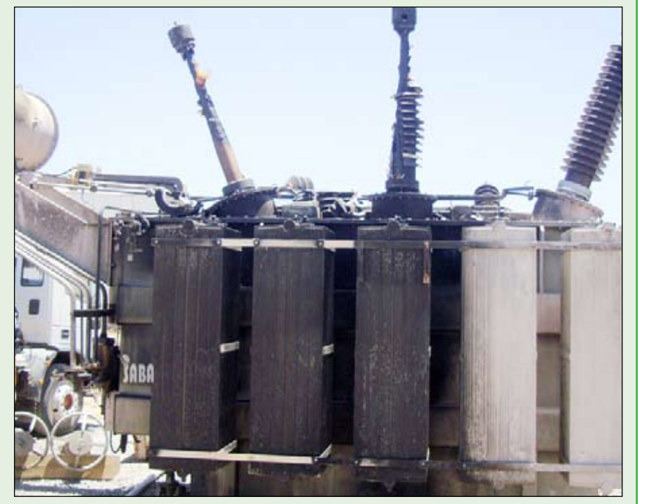
■ المحول الكهربائي المحترق في محطة كهرباء ذمار
