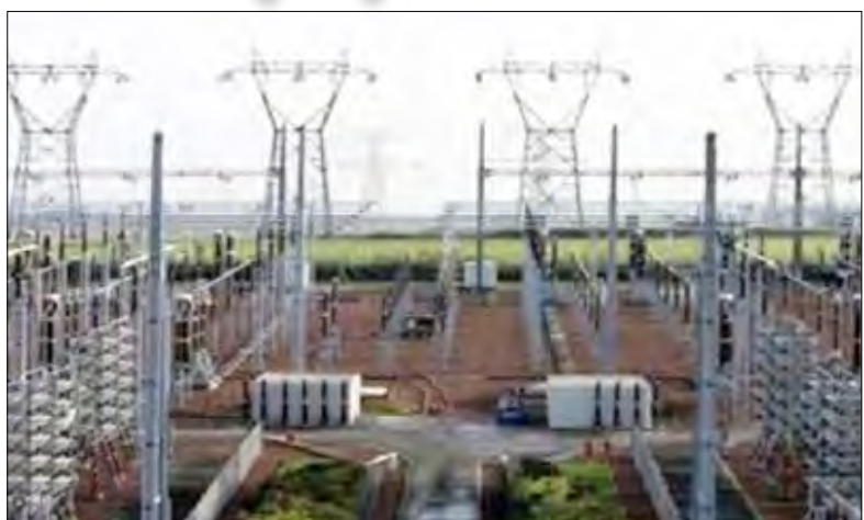
أحد المشاريع الكهربائية
