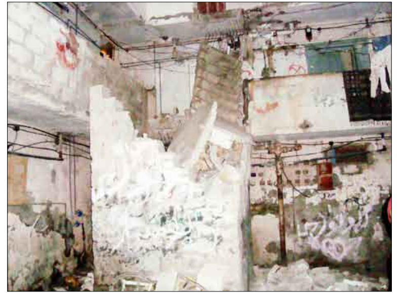
صورتان توضحان حجم الدمار الذي خلفه انهيار سلالم بلوك (5) في القلوعة، والجدران المتهاكلة للبلوكات
