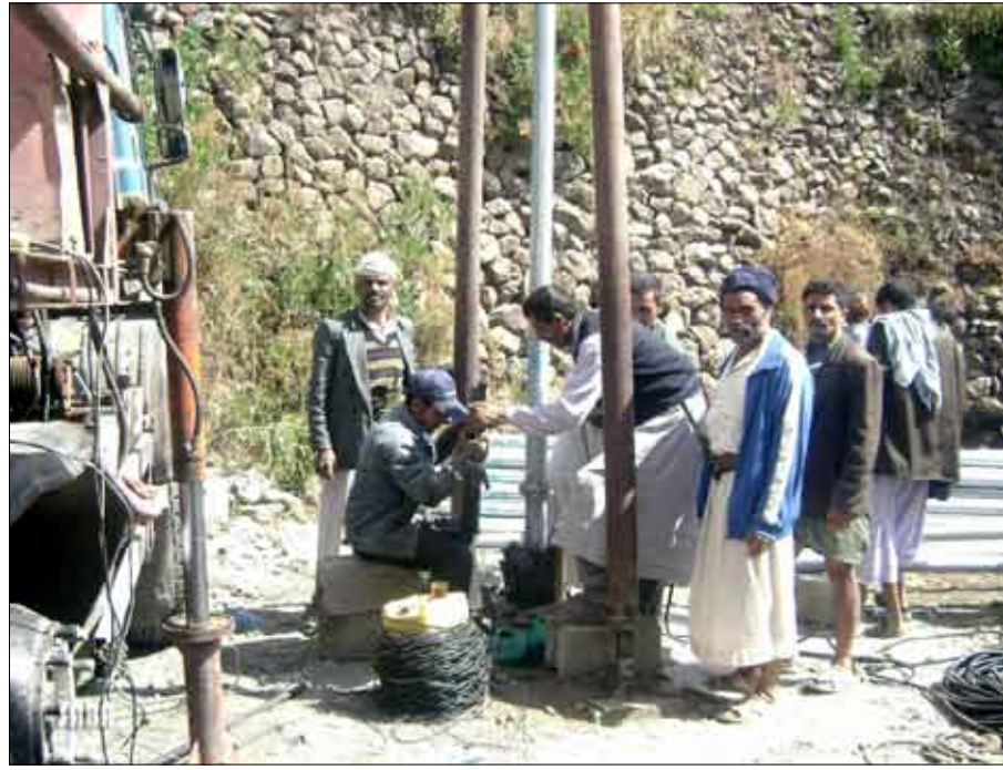
صورة لأحد مشاريع مياه الريف بصنعاء.
