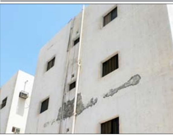
■ تسرب المياه على المباني أدى إلى تشققها
