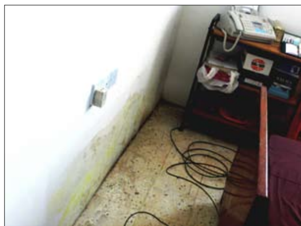
■ رشح المياه من الحمام إلى الغرفة المجاورة في إحدى الشقق
