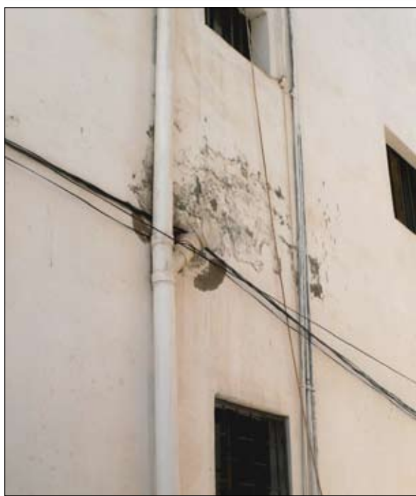
■ آثار تسرب المياه على المباني
