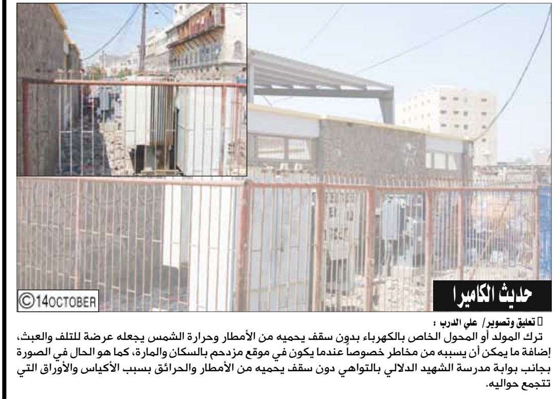
ترك المولد أو المحول الخاص بالكهرباء بدون سقف يحميه من الأمطار وحرارة الشمس يجعله عرضة لتلف العيب، إضافة ما يمكن أن يسببه من مخاطر خصوصاً عندما يكون في موقع مزدحم بالسكان والمارة، كما هو الحال في الصورة بجانب بوابة مدرسة الشهيد الدلاي بالتواهي دون سقف يحميه من الأمطار والحرائق بسبب الاكياس والأوراق التي تتجمع حواله.
