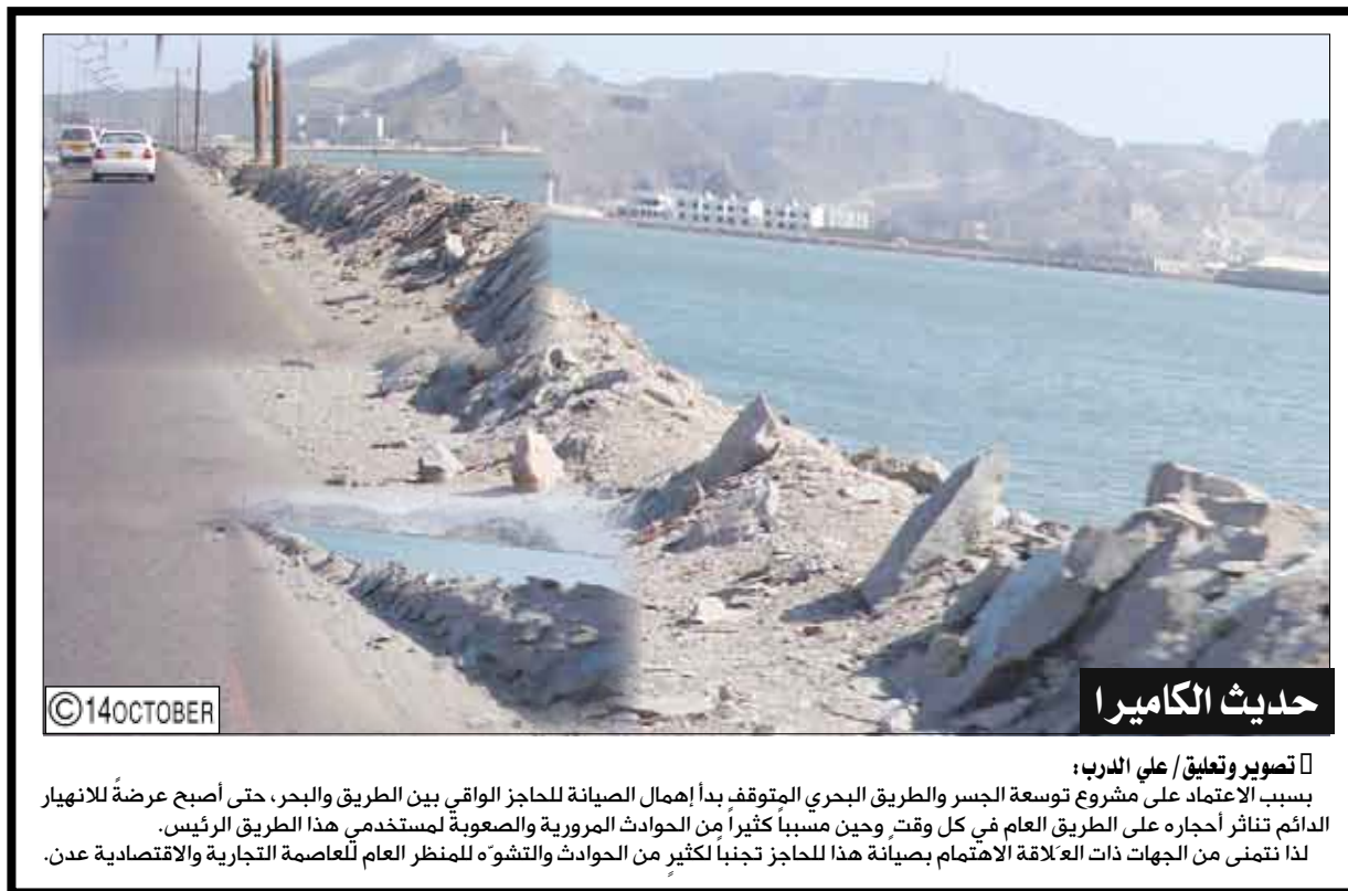
حديث الكاميرا تصوير وتعليق/ علي الدرب: بسبب الاعتماد على مشروع توسعة الجسر والطريق البحري المتوقف بدأ إهمال الصيانة للحاجز الواقي بين الطريق والبحر، حتى أصبح عرضة للانهدام الدائم تناثر أحجاره على الطريق العام في كل وقت وحين مسببا كثيرا من الحوادث المرورية والصعوبة لمستخدمي هذا الطريق الرئيس. لذا نتمنى من الجهات ذات العلاقة الاهتمام بصيانة هذا الحاجز تجنباً لكثير من الحوادث والتشوه للمنظر العام للعاصمة التجارية والاقتصادية عدن.
