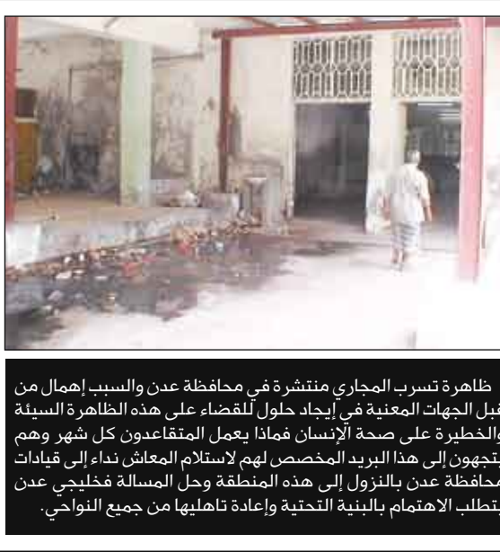
ظاهرة تسرب المجاري منتشرة في محافظة عدن والسبب الإهمال من قبل الجهات المعنية في إيجاد حلول للقضاء على هذه الظاهرة السنية والحطيرة على صحة الإنسان فمئات يعمل المتقاعدون كل شهر وهم يتجهون إلى هذا البريد المخصص لهم لاستلام العاشاء نداء إلى قيادات محافظة عدن بالانزول إلى هذه المنطقة وحل المسألة فخلجي عن يتعطل الإهتمام بالبنية التحتية وإعادة تأهيلها من جميع النواحي.
