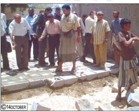
□ عدن/ نعمت عيسى: دشّن الأخ/ أحمد حامد لمّس مدير عام مديرية المنصورة أمس مشروع الرصف للشوارع الداخلية للحياء السكنية بالمديرية بحضور الأخ/ عمر ناصر أمين عام المجلس المحلي بالمديرية.
