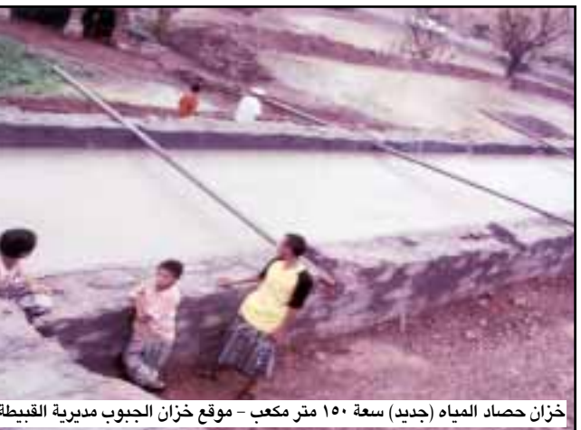
خزان حصاد المياه (جديد) سعة ١٥٠ متر مكعب - موقع خزان الجنوب مديرية القبيطة
